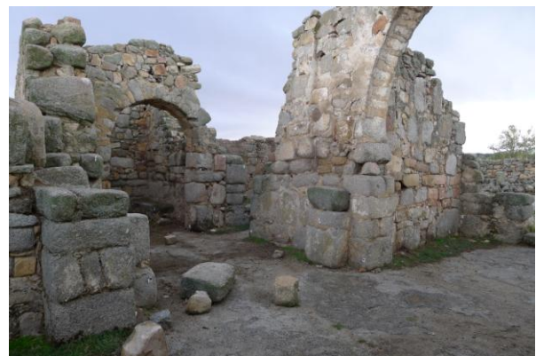
FIGURA 1. Vista parcial de la iglesia de San Pedro de La Mata, construida sobre un lanchar de granito.
