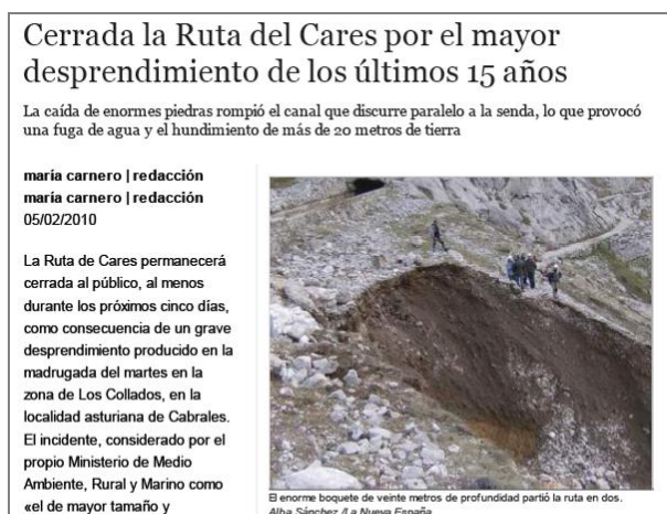
FIGURA 4. Noticia publicada el 05/02/2010 en El Diario de León informando sobre la desestabilización de un depósito de derrubios debido a las filtraciones ocasionadas por la rotura previa del canal, que se puede observar en la parte superior de la fotografía.
